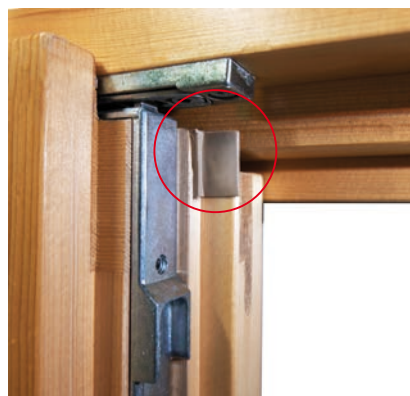
La fuga ha quedado cubierta
